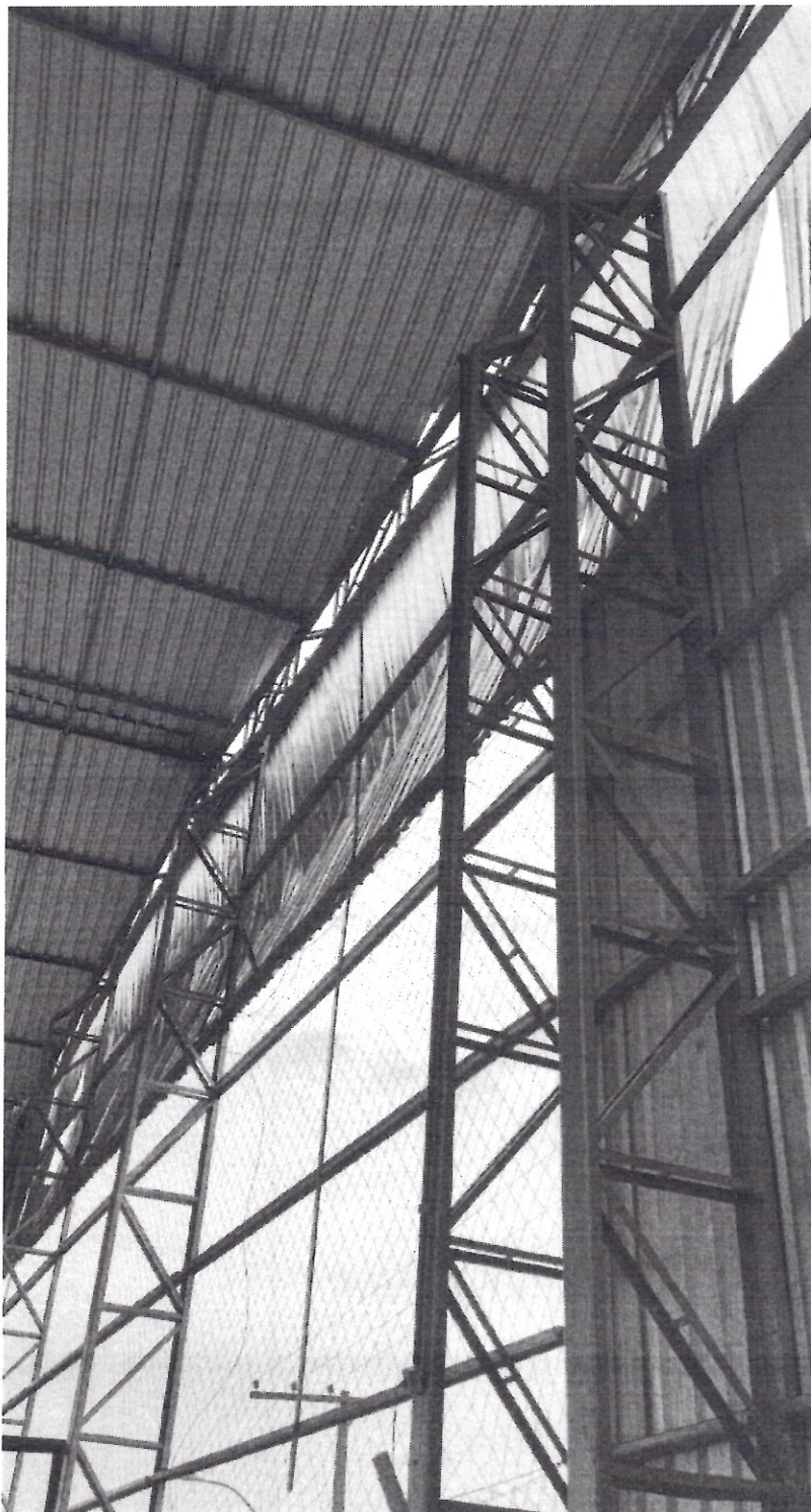
Imagem 03: Quadra Poliesportiva do Distrito do Campestrinho com a presença de danos em seu fechamento lateral. – Arquivo da Divisão de Planejamento Urbano.
