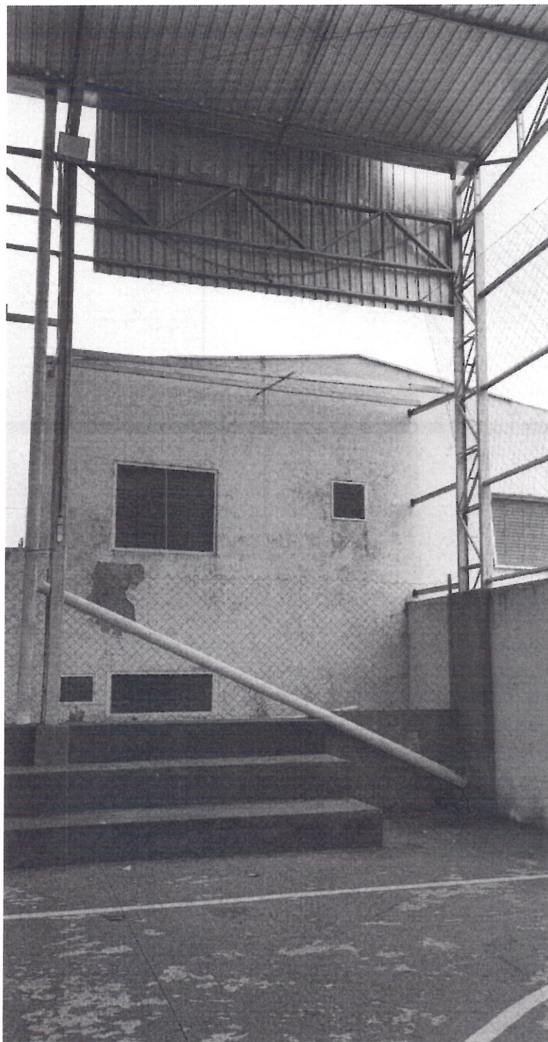
Imagem 02: Quadra Poliesportiva do Distrito do Campestrinho com a presença de danos em seu fechamento lateral. – Arquivo da Divisão de Planejamento Urbano.
