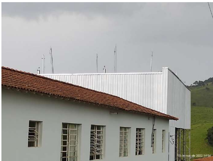
Imagem 39: Parte das instalações do sistema SPDA tiveram suas posições alteradas pelo vento, podendo ter sido afetada a integridade do sistema, na de Quadra Poliesportiva do Distrito do Campestrinho. Arquivo da Divisão de Planejamento Urbano e Projetos.
