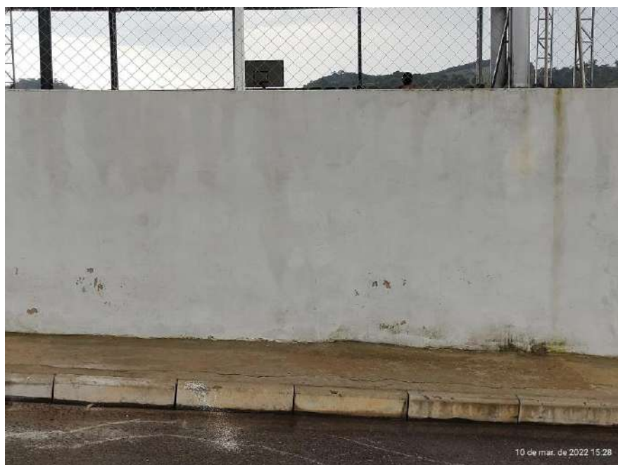
Imagem 37: Inconformidades visíveis na pintura externa, na Quadra Poliesportiva do Distrito do Campestrinho. Arquivo da Divisão de Planejamento Urbano e Projetos.
