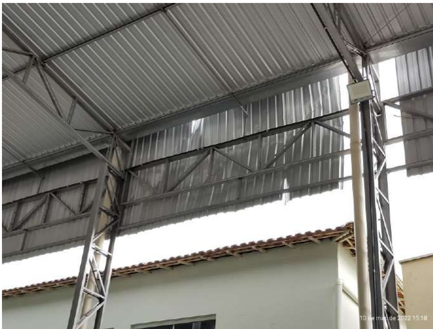
Imagem 11: Telhas do fechamento lateral danificadas, na Quadra Poliesportiva do Distrito do Campestrinho. Arquivo da Divisão de Planejamento Urbano e Projetos.
