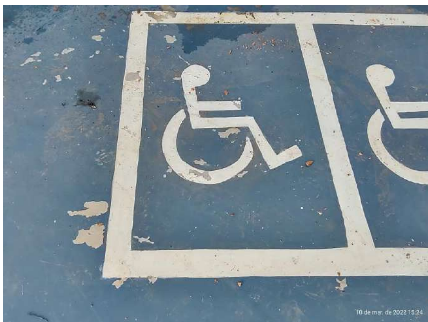
Imagem 27: Trincas, manchas e falhas na pintura do piso da quadra poliesportiva, na Quadra Poliesportiva do Distrito do Campestrinho. Arquivo da Divisão de Planejamento Urbano e Projetos.
