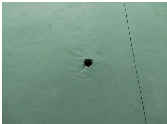
Imagem 02: Detalhe de trecho de piso da quadra que apresenta desnível e acabamento insatisfatório. – Divisão de Planejamento Urbano e Meio Ambiente.
