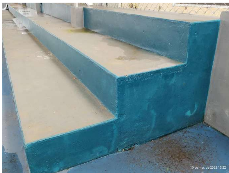
Imagem 25: Inconformidades visíveis na pintura do local, na Quadra Poliesportiva do Distrito do Campestrinho. Arquivo da Divisão de Planejamento Urbano e Projetos.
