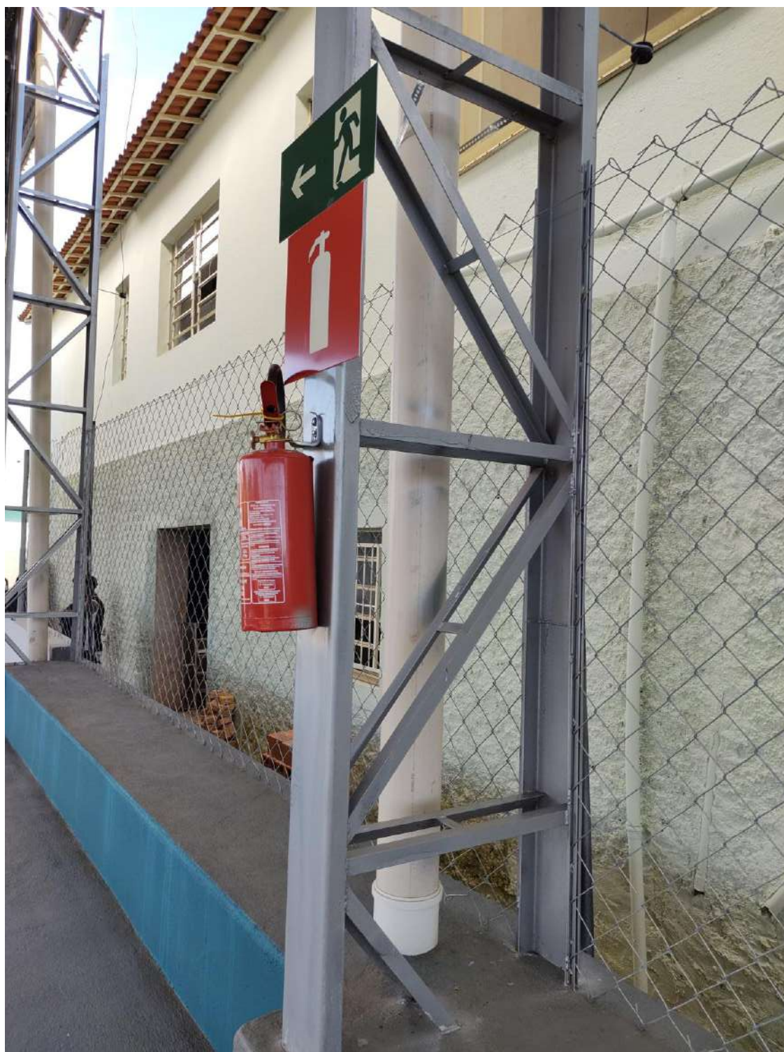
Imagem 21: Extintor manchado em pintura da estrutura metálica da quadra poliesportiva, na obra de Construção de Quadra Poliesportiva do Distrito do Campestrinho. Arquivo da Divisão de Planejamento Urbano e Projetos.
