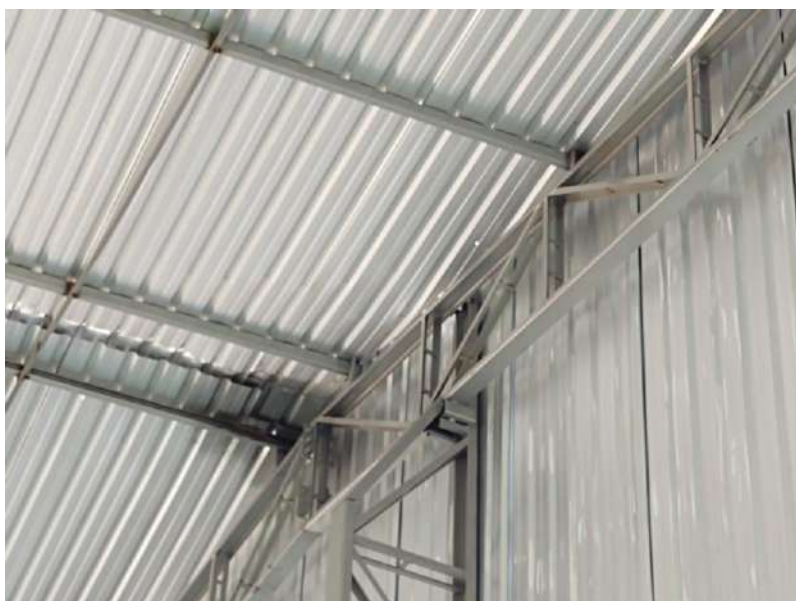
Imagem 27: Pintura da estrutura metálica da quadra poliesportiva manchada e/ou com sinais de ferrugem, bem como furos na cobertura, na obra de Construção de Quadra Poliesportiva do Distrito do Campestrinho. Arquivo da Divisão de Planejamento Urbano e Projetos.
