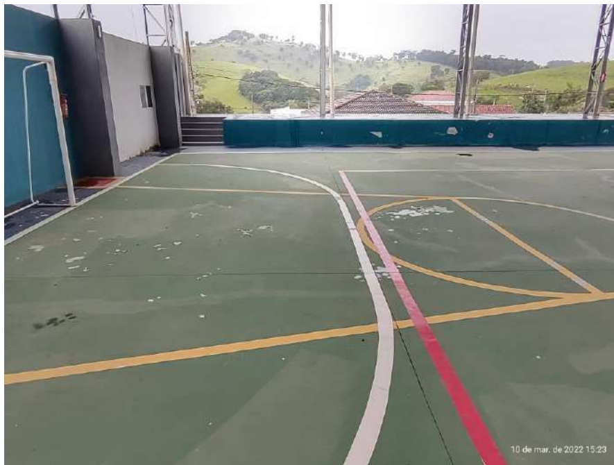
Imagem 26: Trincas, manchas e falhas na pintura do piso da quadra poliesportiva, na Quadra Poliesportiva do Distrito do Campestrinho. Arquivo da Divisão de Planejamento Urbano e Projetos.
