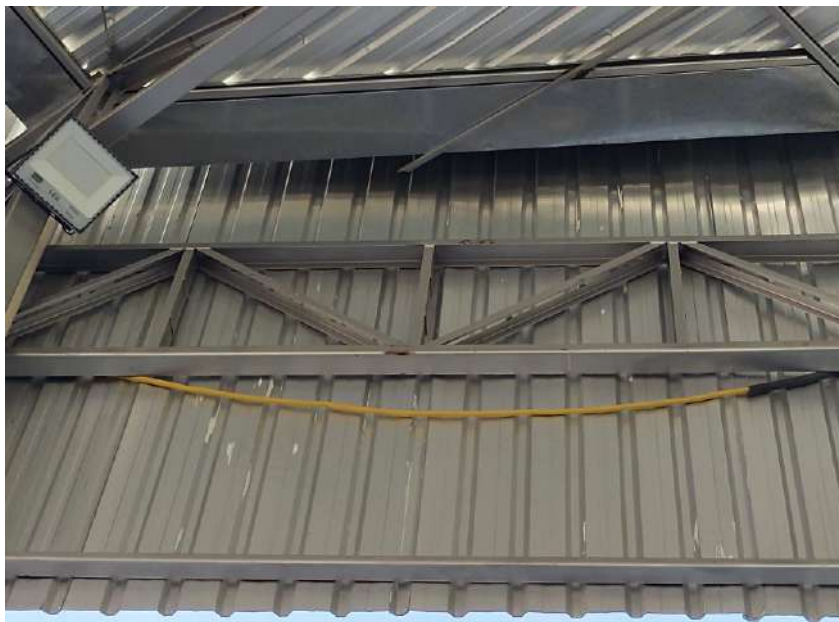
Imagem 26: Conduíte flexível solto, na obra de Construção de Quadra Poliesportiva do Distrito do Campestrinho. Arquivo da Divisão de Planejamento Urbano e Projetos.
