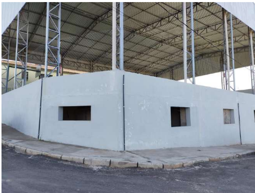
Imagem 02: Pintura externa manchada, na obra de Construção de Quadra Poliesportiva do Distrito do Campestrinho. Arquivo da Divisão de Planejamento Urbano e Projetos.
