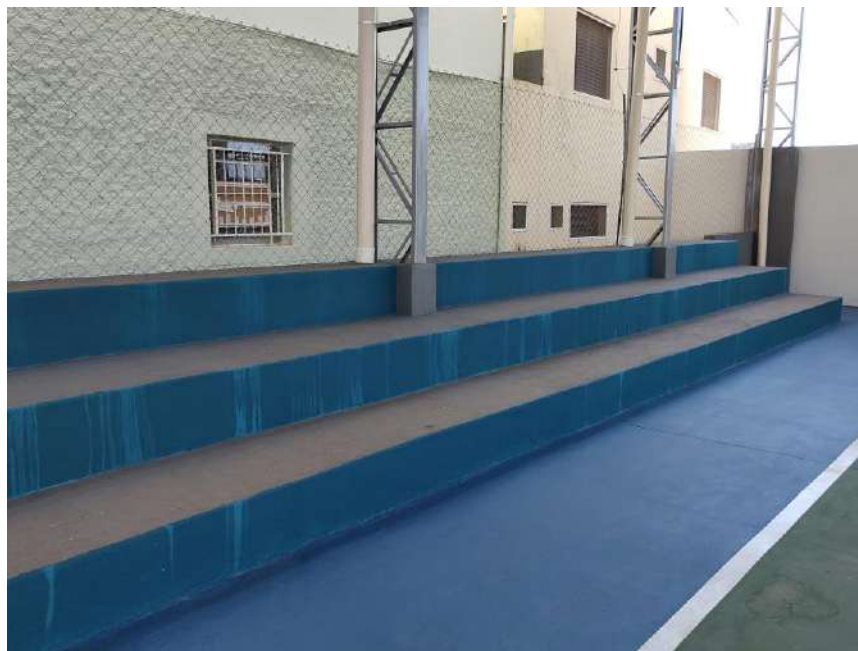
Imagem 08: Manchas nas alvenarias pintadas cor mapa-mundi, na obra de Construção de Quadra Poliesportiva do Distrito do Campestrinho. Arquivo da Divisão de Planejamento Urbano e Projetos.
