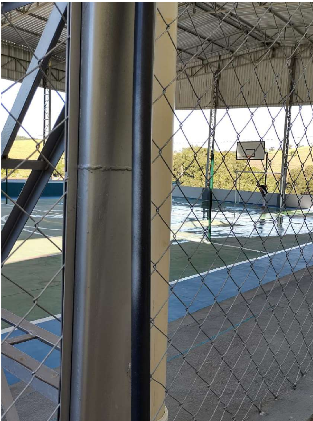
Imagem 25: Eletroduto rígido manchado em pintura da estrutura metálica da quadra poliesportiva, na obra de Construção de Quadra Poliesportiva do Distrito do Campestrinho. Arquivo da Divisão de Planejamento Urbano e Projetos.
