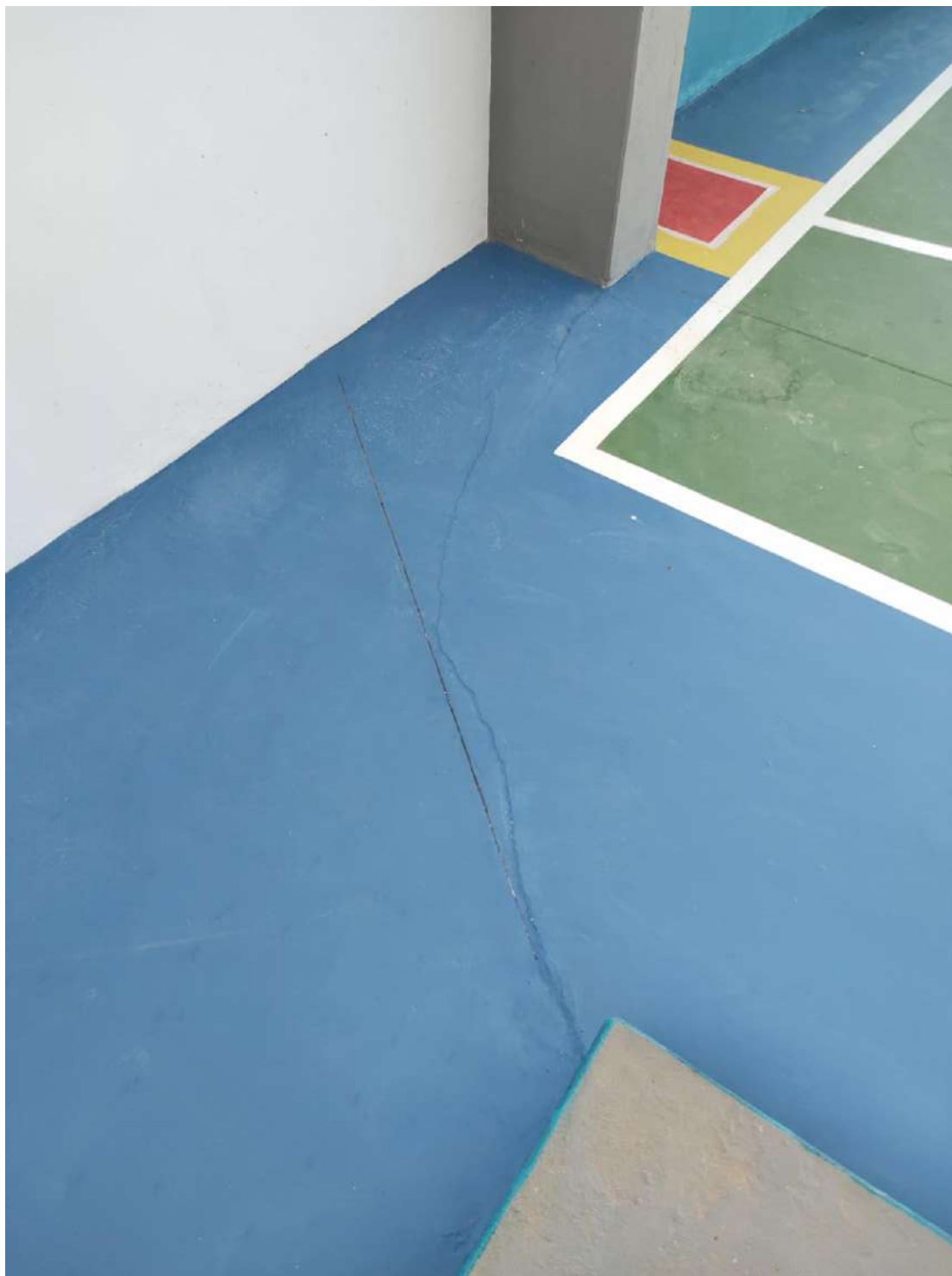
Imagem 34: Trincas no piso da quadra poliesportiva, na obra de Construção de Quadra Poliesportiva do Distrito do Campestrinho. Arquivo da Divisão de Planejamento Urbano e Projetos.
