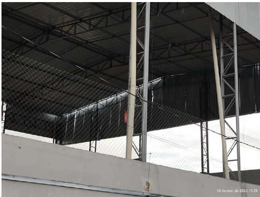
Imagem 02: Vãos existentes entre a cobertura e o fechamento lateral da Quadra Poliesportiva do Distrito do Campestrinho. Arquivo da Divisão de Planejamento Urbano e Projetos.
