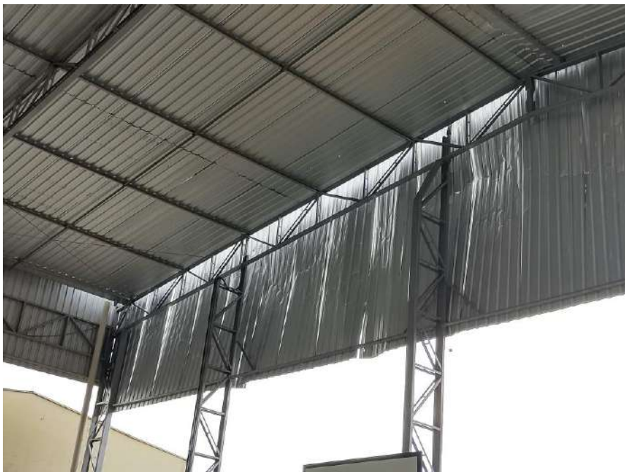
Imagem 09: Telhas do fechamento lateral danificadas, na Quadra Poliesportiva do Distrito do Campestrinho. Arquivo da Divisão de Planejamento Urbano e Projetos.
