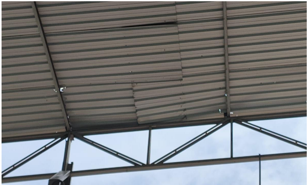
Imagem 04: Quadra Poliesportiva do Distrito do Campestrinho com telhas da cobertura com extremidades soltas. – Arquivo da Divisão de Planejamento Urbano.
