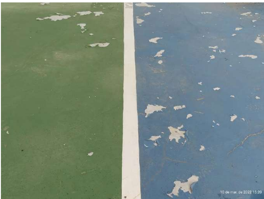
Imagem 21: Manchas e falhas na pintura do piso da quadra poliesportiva, na Quadra Poliesportiva do Distrito do Campestrinho. Arquivo da Divisão de Planejamento Urbano e Projetos.
