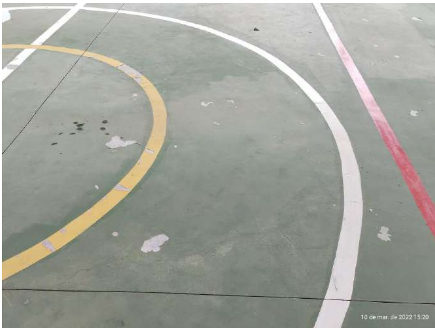
Imagem 20: Manchas e falhas na pintura do piso da quadra poliesportiva, na Quadra Poliesportiva do Distrito do Campestrinho. Arquivo da Divisão de Planejamento Urbano e Projetos.
