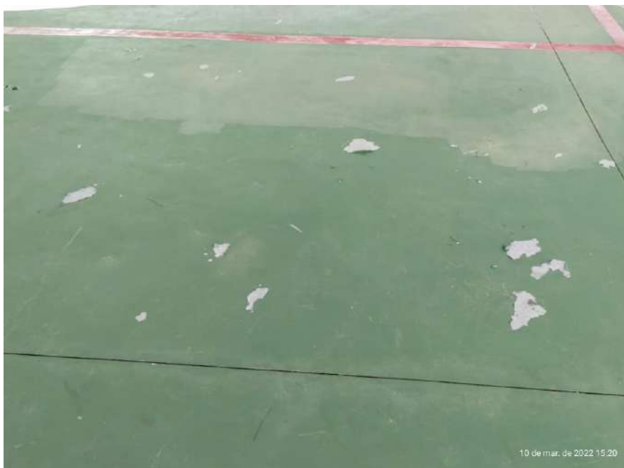
Imagem 19: Manchas e falhas na pintura do piso da quadra poliesportiva, na Quadra Poliesportiva do Distrito do Campestrinho. Arquivo da Divisão de Planejamento Urbano e Projetos.
