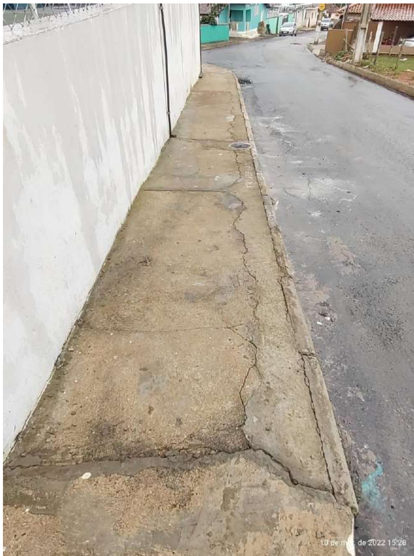
Imagem 34: Trincas no piso da calçada, na Quadra Poliesportiva do Distrito do Campestrinho. Arquivo da Divisão de Planejamento Urbano e Projetos.
