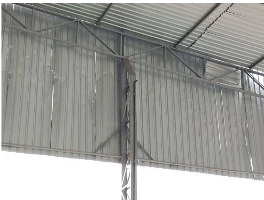
Imagem 12: Telhas do fechamento lateral danificadas, na Quadra Poliesportiva do Distrito do Campestrinho. Arquivo da Divisão de Planejamento Urbano e Projetos.
