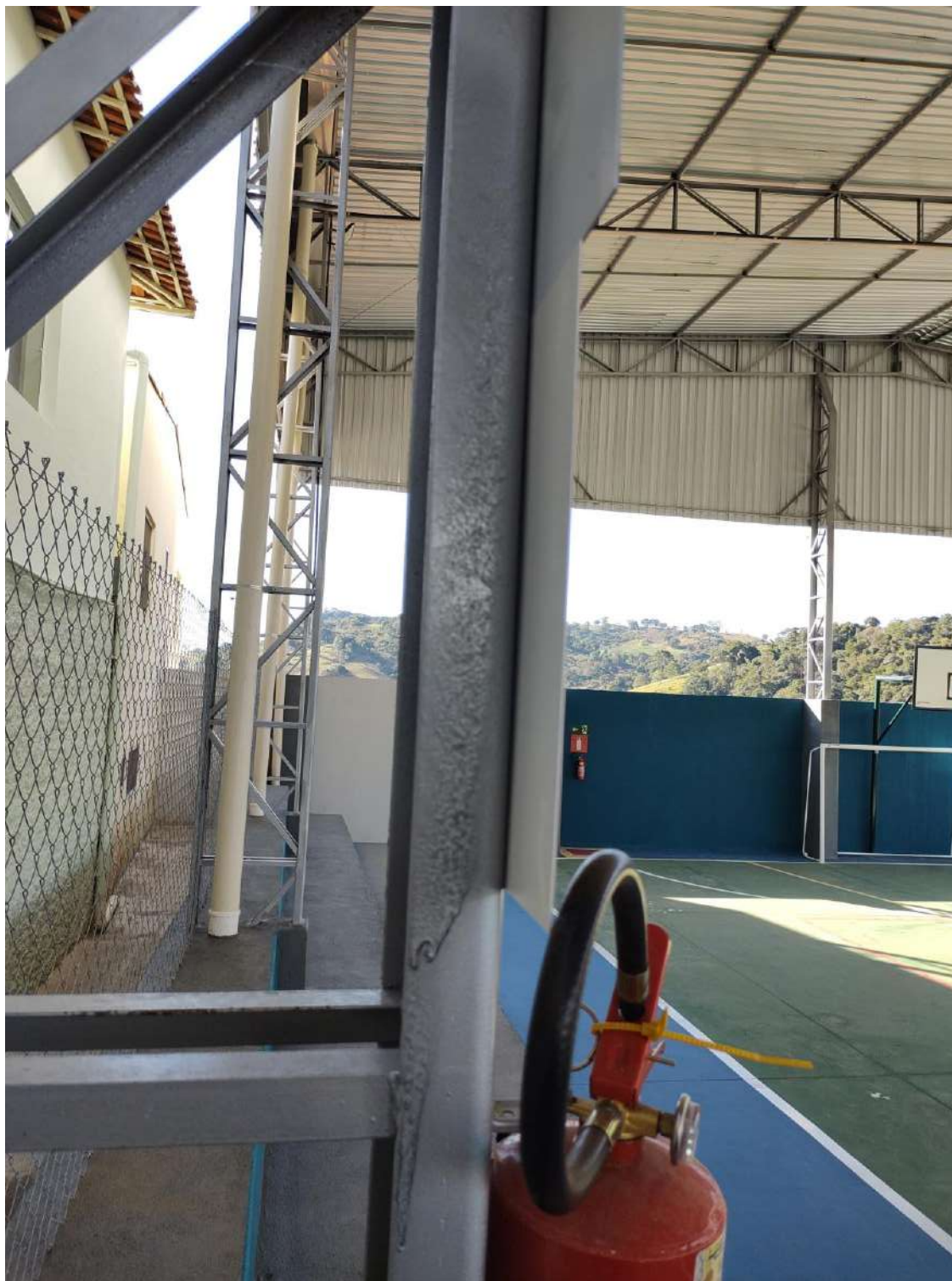
Imagem 18: Pintura da estrutura metálica da quadra poliesportiva manchada, na obra de Construção de Quadra Poliesportiva do Distrito do Campestrinho. Arquivo da Divisão de Planejamento Urbano e Projetos.
