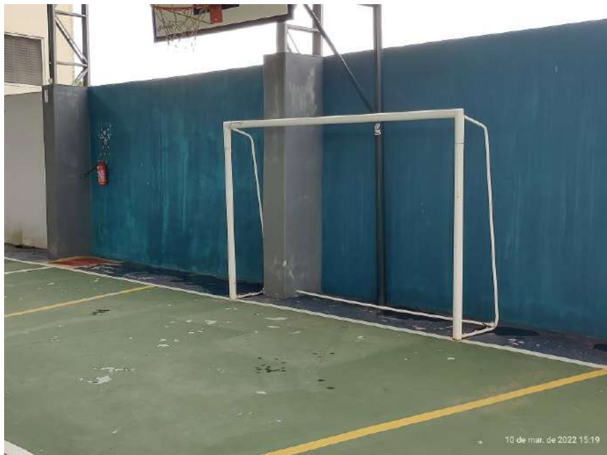
Imagem 18: Inconformidades visíveis na pintura do local, na Quadra Poliesportiva do Distrito do Campestrinho. Arquivo da Divisão de Planejamento Urbano e Projetos.
