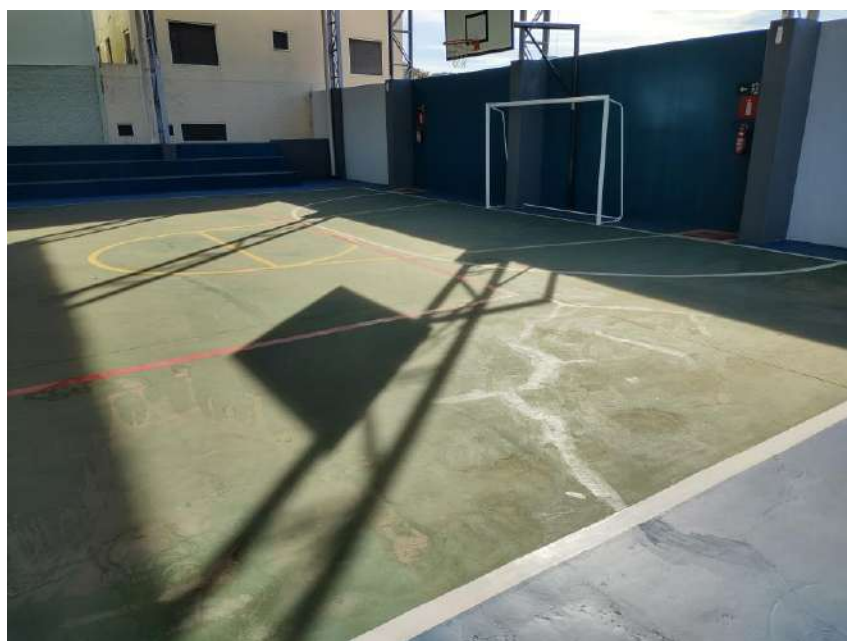
Imagem 13: Pintura no piso da quadra poliesportiva manchada, na obra de Construção de Quadra Poliesportiva do Distrito do Campestrinho. Arquivo da Divisão de Planejamento Urbano e Projetos.
