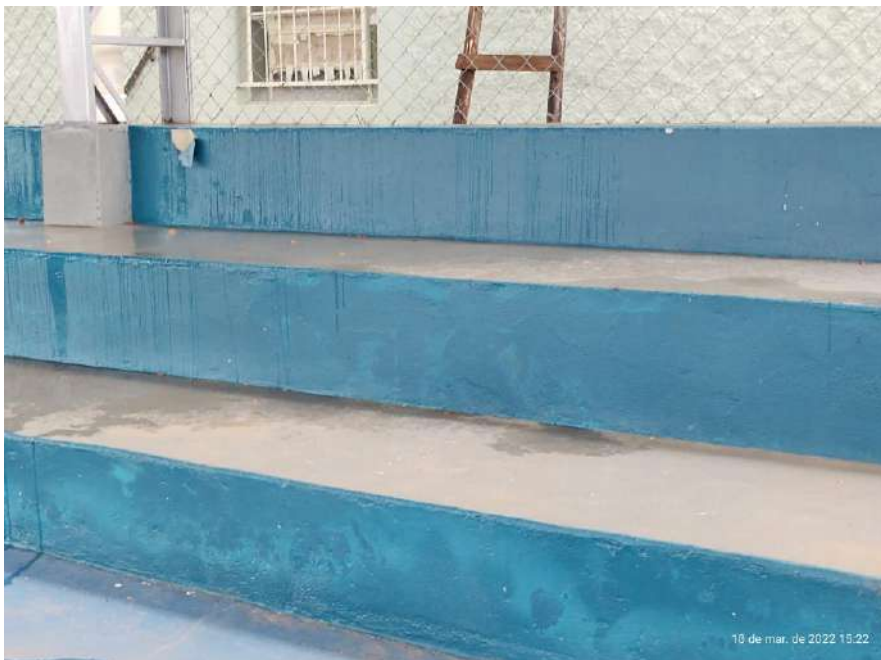
Imagem 24: Inconformidades visíveis na pintura do local, na Quadra Poliesportiva do Distrito do Campestrinho. Arquivo da Divisão de Planejamento Urbano e Projetos.
