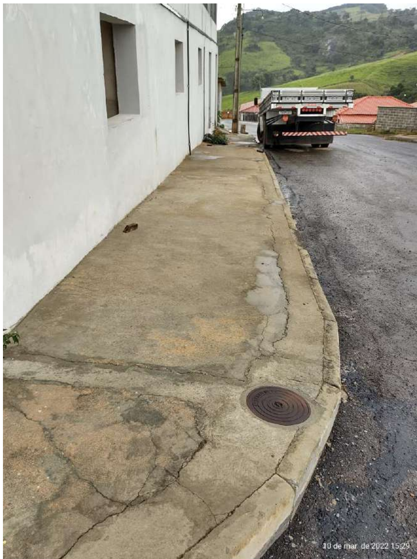
Imagem 35: Trincas no piso da calçada, na Quadra Poliesportiva do Distrito do Campestrinho. Arquivo da Divisão de Planejamento Urbano e Projetos.
