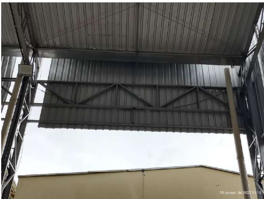
Imagem 10: Telhas do fechamento lateral danificadas, na Quadra Poliesportiva do Distrito do Campestrinho. Arquivo da Divisão de Planejamento Urbano e Projetos.
