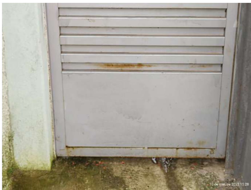
Imagem 32: Portão de acesso lateral da quadra poliesportiva com sinais de ferrugem, na Quadra Poliesportiva do Distrito do Campestrinho. Arquivo da Divisão de Planejamento Urbano e Projetos.
