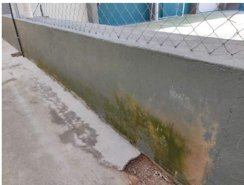
Imagem 03: Pintura atrás da arquibancada manchada, na obra de Construção de Quadra Poliesportiva do Distrito do Campestrinho. Arquivo da Divisão de Planejamento Urbano e Projetos.
