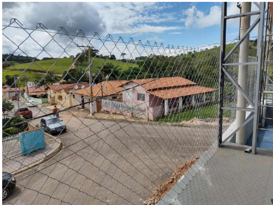
Imagem 08: Alambrado instalado fora das especificações da planilha orçamentária. Arquivo da Divisão de Planejamento Urbano e Projetos.
