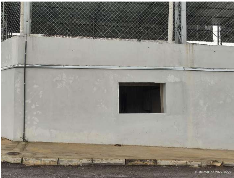
Imagem 38: Inconformidades visíveis na pintura externa, na Quadra Poliesportiva do Distrito do Campestrinho. Arquivo da Divisão de Planejamento Urbano e Projetos.
