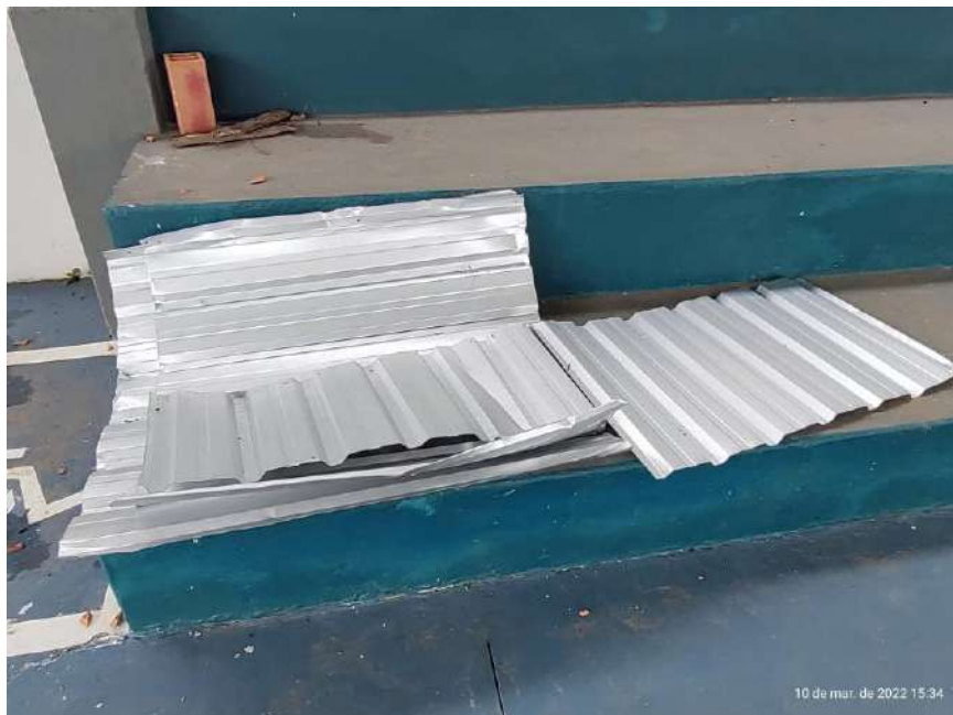
Imagem 14: Telhas que se desprenderam do fechamento lateral, na Quadra Poliesportiva do Distrito do Campestrinho. Arquivo da Divisão de Planejamento Urbano e Projetos.
