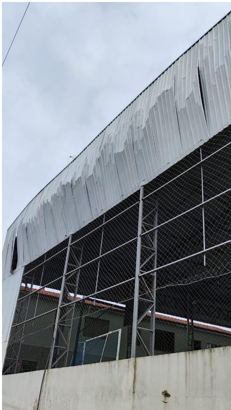
Imagem 01: Quadra Poliesportiva do Distrito do Campestrinho com a presença de danos em seu fechamento lateral. – Arquivo da Divisão de Planejamento Urbano.
