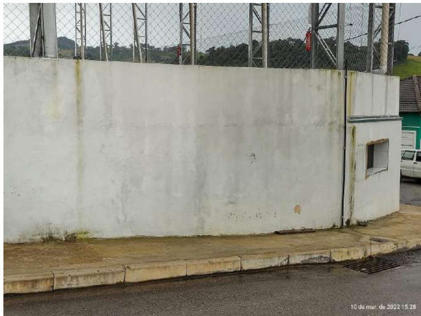
Imagem 36: Inconformidades visíveis na pintura externa, na Quadra Poliesportiva do Distrito do Campestrinho. Arquivo da Divisão de Planejamento Urbano e Projetos.
