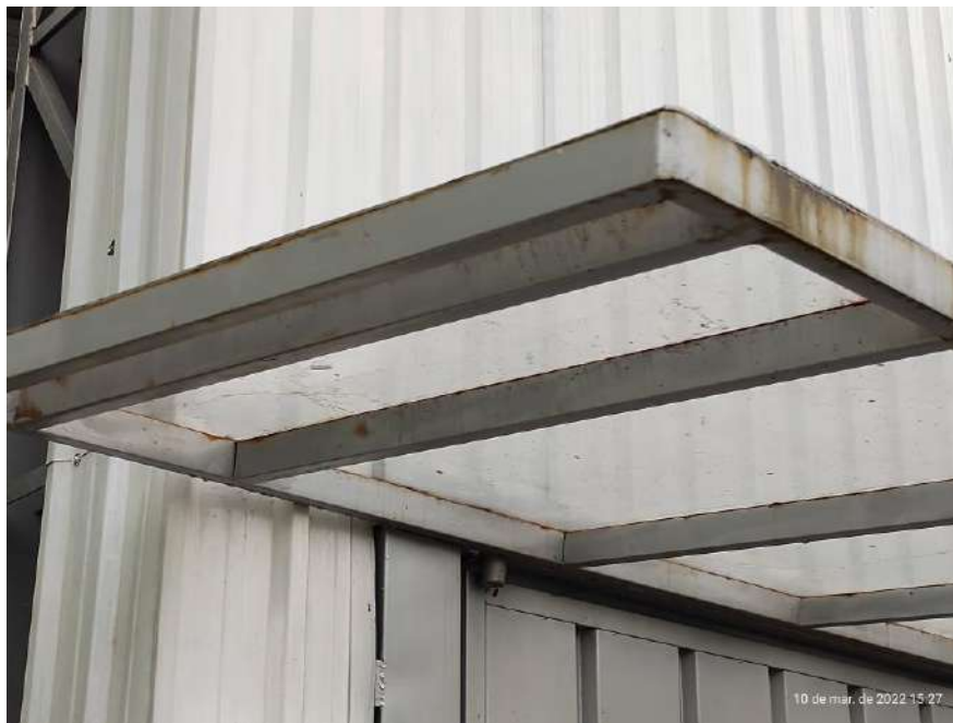
Imagem 31: Pergolado de cobertura da entrada da quadra poliesportiva com sinais de ferrugem, na Quadra Poliesportiva do Distrito do Campestrinho. Arquivo da Divisão de Planejamento Urbano e Projetos.
