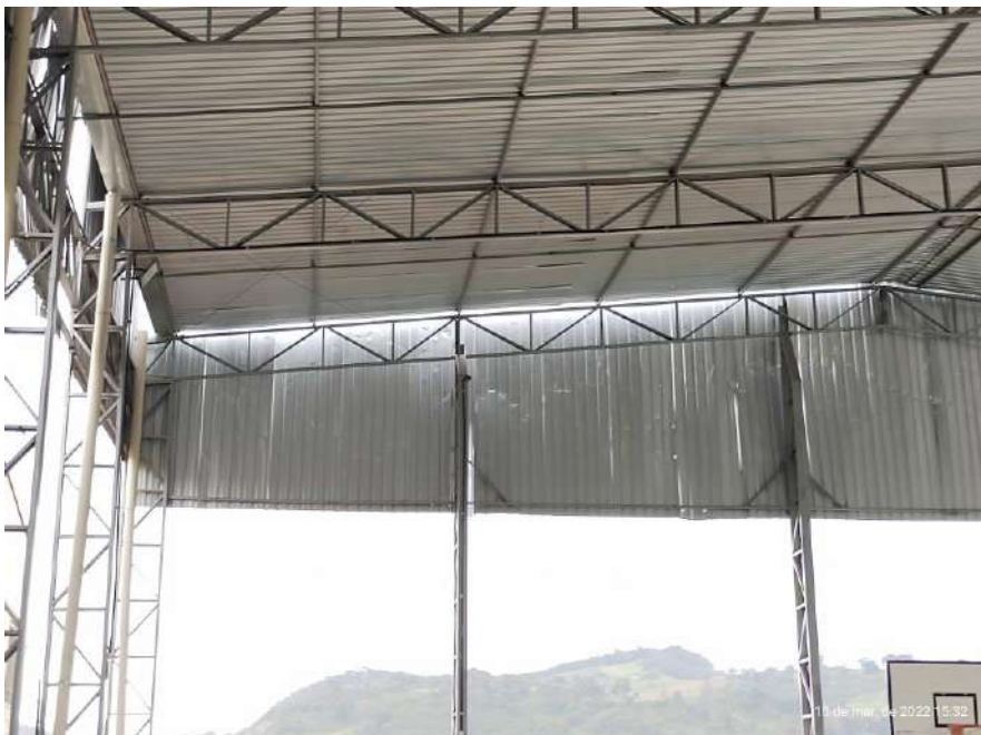
Imagem 05: Vãos existentes entre a cobertura e o fechamento lateral da Quadra Poliesportiva do Distrito do Campestrinho. Arquivo da Divisão de Planejamento Urbano e Projetos.
