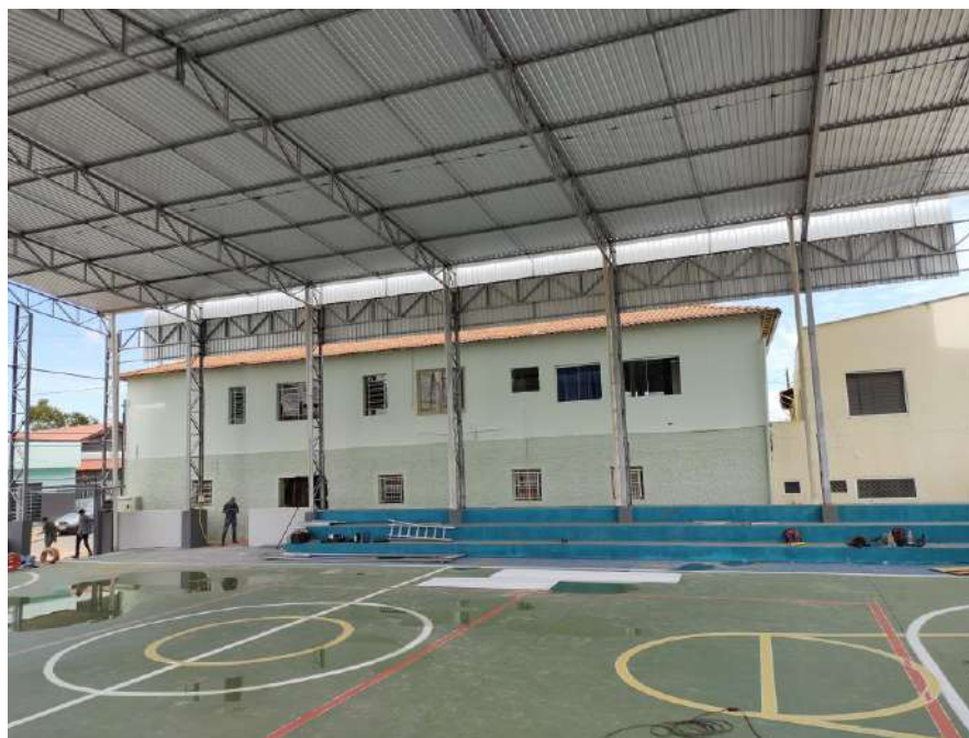
Imagem 07: Pintura do piso da quadra e de parte das alvenarias necessita de reparos, visto os danos provocados pelos demais serviços executados no local. Arquivo da Divisão de Planejamento Urbano e Projetos.
