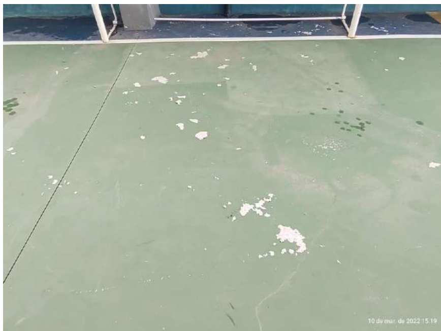
Imagem 15: Manchas e falhas na pintura do piso da quadra poliesportiva, na Quadra Poliesportiva do Distrito do Campestrinho. Arquivo da Divisão de Planejamento Urbano e Projetos.
