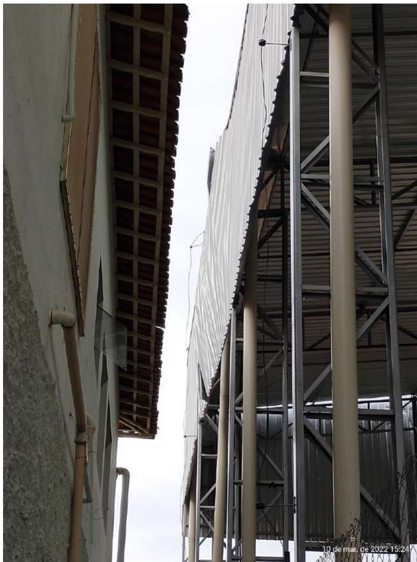
Imagem 13: Telhas do fechamento lateral danificadas, na Quadra Poliesportiva do Distrito do Campestrinho. Arquivo da Divisão de Planejamento Urbano e Projetos.
