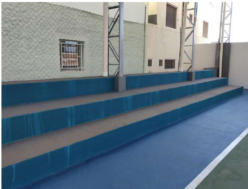
Imagem 08: Manchas nas alvenarias pintadas cor mapa-mundi, na obra de Construção de Quadra Poliesportiva do Distrito do Campestrinho. Arquivo da Divisão de Planejamento Urbano e Projetos.
