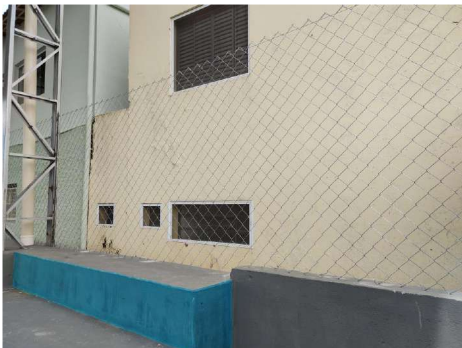
Imagem 09: Alambrado instalado fora das especificações da planilha orçamentária. Arquivo da Divisão de Planejamento Urbano e Projetos.
