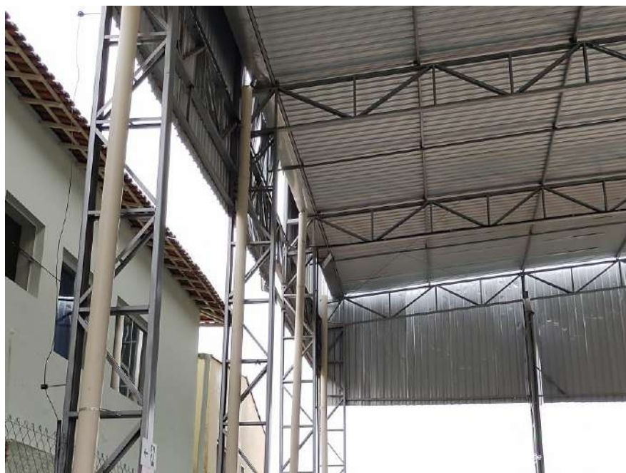
Imagem 06: Vãos existentes entre a cobertura e o fechamento lateral da Quadra Poliesportiva do Distrito do Campestrinho. Arquivo da Divisão de Planejamento Urbano e Projetos.
