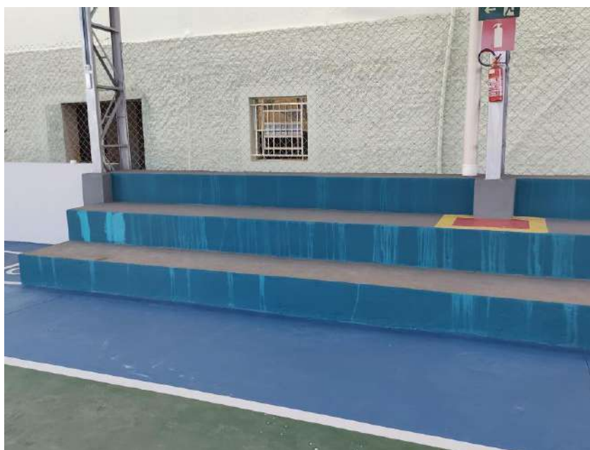
Imagem 09: Manchas nas alvenarias pintadas cor mapa-mundi, na obra de Construção de Quadra Poliesportiva do Distrito do Campestrinho. Arquivo da Divisão de Planejamento Urbano e Projetos.
